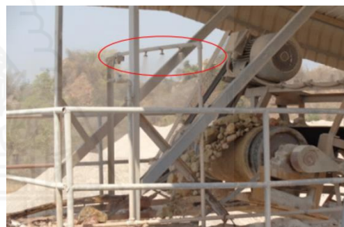
ง. ระบบสเปรย์น้ำบริเวณปลายสายพานลำเลียง
