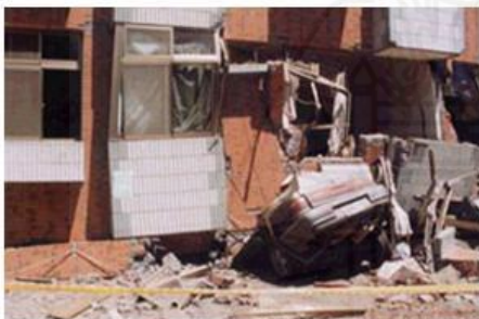
ภายหลังแผ่นดินไหวขนาด 7.2 ริกเตอร์ ของวันที่ 17 มกราคม 2538 ที่เมืองโกเบ ญี่ปุ่น ทำให้ท่อแก๊สรั่วไหล ก่อให้เกิดไฟไหม้มีประชาชนเสียชีวิตมากมาย
