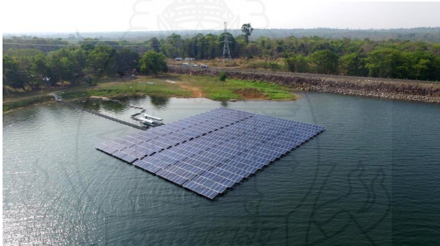
ภาพที่ 15 การติดตั้งแผงโซลาร์เซลล์ลอยอยู่บนผิวน้ำ (Solar Floating)
