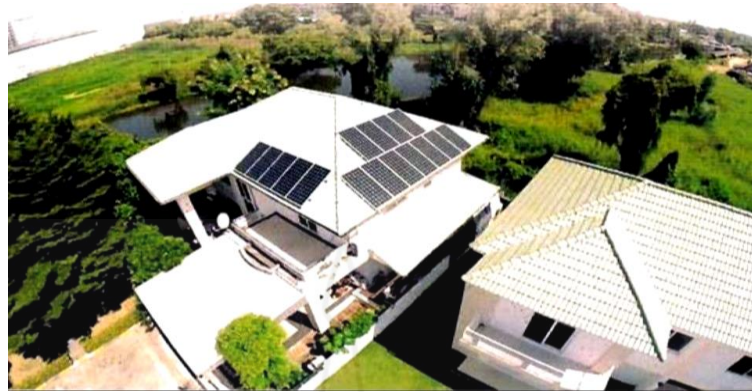
ภาพที่ 13 การติดตั้งแผงโซลาร์เซลล์บนหลังคา (Solar Rooftop) ที่มา : รัฐจักโซลาร์เซลล์ระบบผลิตไฟฟ้าจากแสงอาทิตย์ สำนักงานนโยบายและแผนพลังงาน กระทรวงพลังงาน (ม.ป.ป.)
