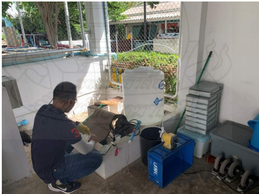
การติดตั้งเครื่องจ่ายสารเคมีฆ่าเชื้อด้วยกรดเปอร์อะซิติก
