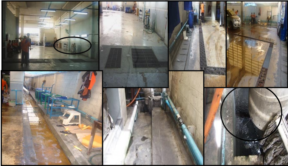
ภาพที่ 3.5 รางระบายน้ำพื้นที่เช็ดรถ และบ่อดักตะกอน ที่มา : บริษัท โตโยต่านนท์บุรี ผู้จำหน่ายโตโยต้า จำกัด (2564)
