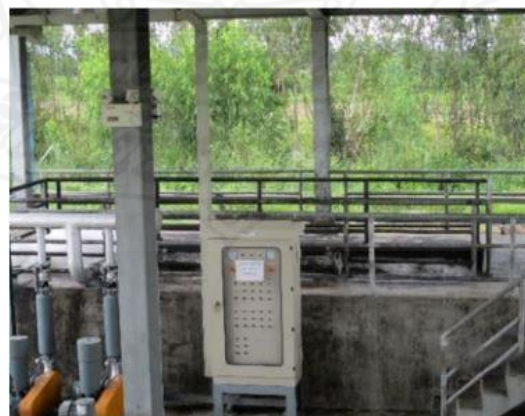
ภาพที่ 5.15 ระบบบำบัดน้ำเสีย
