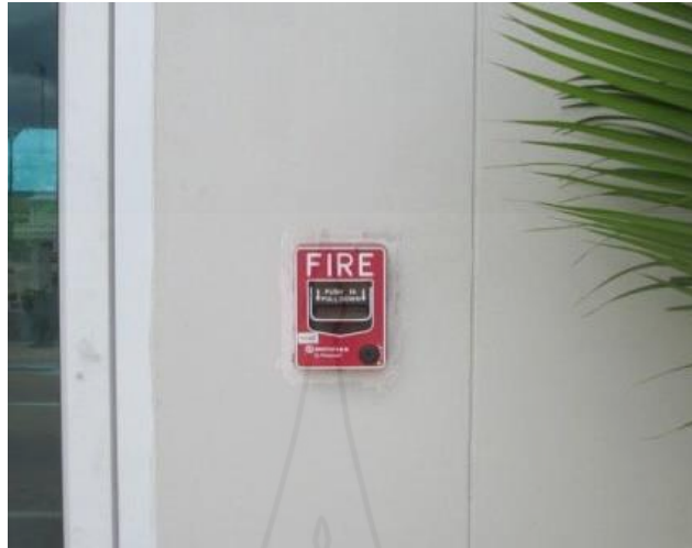
ภาพที่ 5.51 สวิตช์กดแจ้งเหตุฉุกเฉินด้วยมือ
