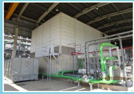
รูปที่ 3-15 อาคารปิดครอบอุปกรณ์ที่มีเสียงดัง
