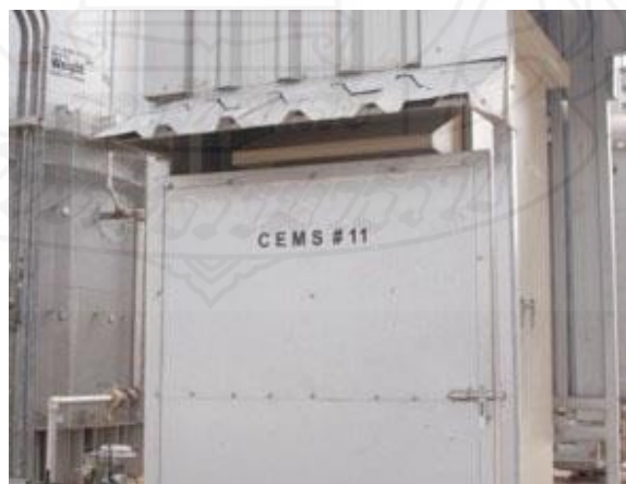
ภาพที่ 5.2 ระบบตรวจสอบคุณภาพอากาศจากปล่องแบบอัตโนมัติอย่างต่อเนื่อง (CEMS) ที่มา :บริษัท เอ็นไวรอนเม้นท์ รีเสิร์จ แอนด์ เทคโนโลยี จำกัด (2561,น.85)
