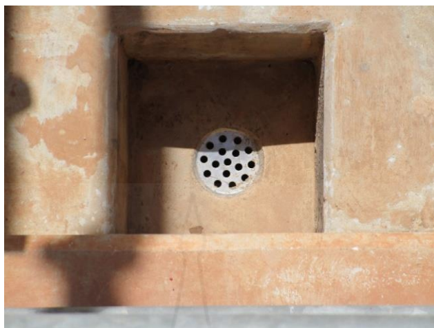
ภาพที่ 5.10 รางระบายน้ำฝนที่ตกในพื้นที่ที่อาจปนเปื้อนในกระบวนการผลิต ที่มา : บริษัท เอ็นไวรอนเมนท์รีเสริจ แอนด์ เทคโนโลยี จำกัด (2561,น. 84)
