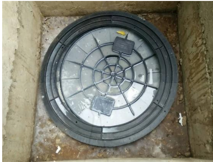
ภาพที่ 5.12 ถังบำบัดน้ำเสียสำเร็จรูปที่ใช้สำหรับบำบัดน้ำเสียที่เกิดจากการการอุปโภค และบริโภคของพนักงาน
