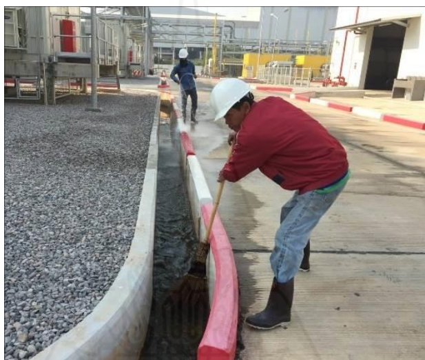
ภาพที่ 5.34 ขุดลอกตะกอนภายในรางระบายน้ำของโรงงาน ที่มา : บริษัท เอ็นไวรอนเมนท์ รีเสิร์จ แอนด์ เทคโนโลยี จำกัด (2561, น. 89)
