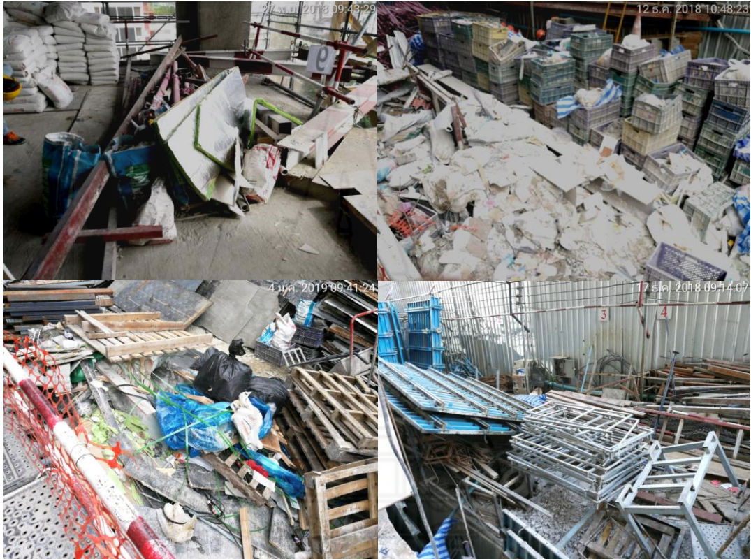
ภาพที่ 1.1 เศษวัสดุก่อสร้างที่ไม่มีการจัดเก็บที่ถูกต้อง
