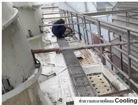
ภาพที่ 4.4 ซ่อมบำรุงเครื่องจักรที่มีสภาพชำรุด
