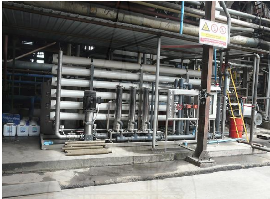
ภาพที่ ค.12 ระบบปรับปรุงคุณภาพน้ำ (เครื่องกรองน้ำ RO ระดับอุตสาหกรรม)
