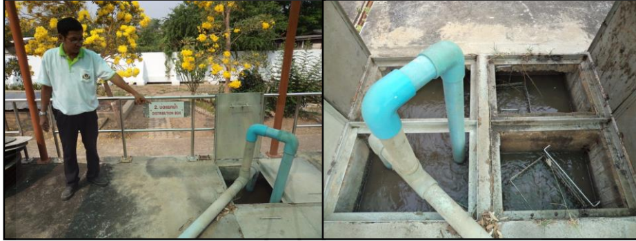
ภาพที่ 2.23 บ่อแยกน้ำ (Distribution Box)
