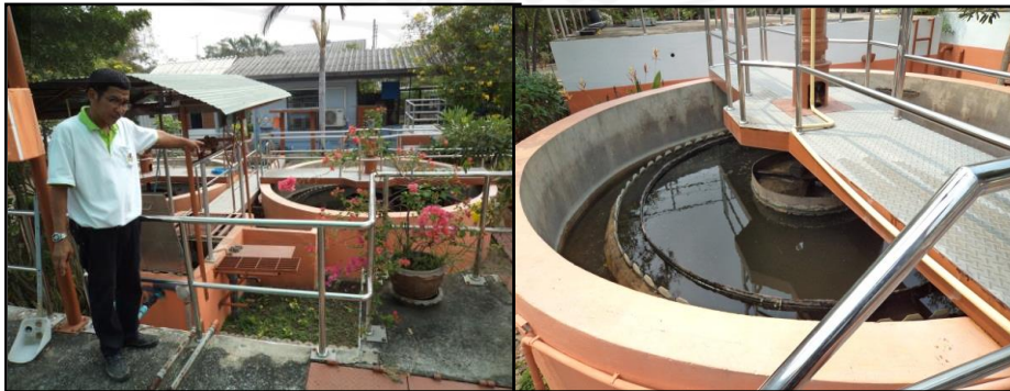
ภาพที่ 2.25 บ่อดกตะกอน 1, 2 (Sedimentation Tank 1, 2)
