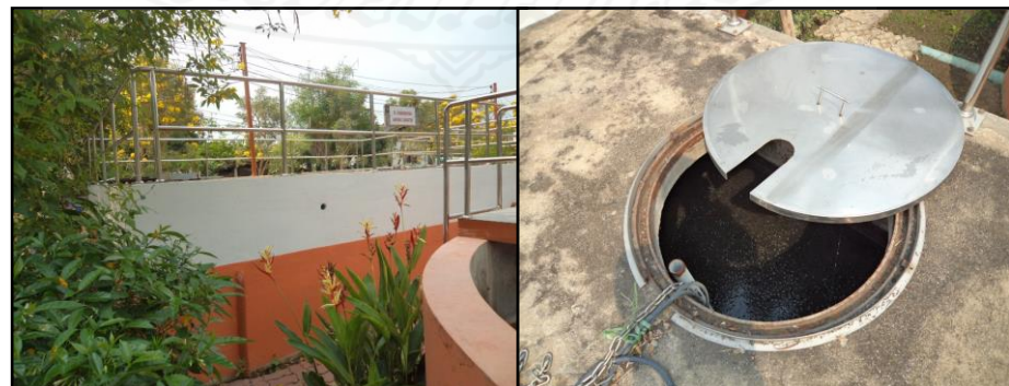
ภาพที่ 2.28 บ่อย่อยตะกอน (Aerobic Digester)
