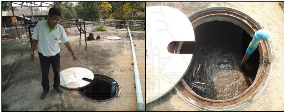
ภาพที่ 2.24 บ่อเติมอากาศ 1,2 (Aeration Tank 1,2)
