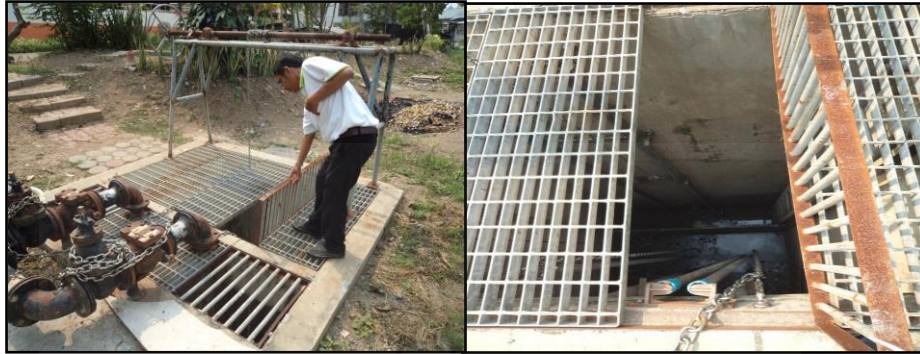
ภาพที่ 2.20 บ่อรวบรวมน้ำเสียหรือบ่อสูบน้ำยกระดับ (Pump Sump : Existing)
