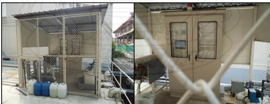
ภาพที่ 2.37 ห้องควบคุมระบบบำบัดน้ำเสียแบบชีวภาพผสม โรงพยาบาลพระนครศรีอยุธยา
