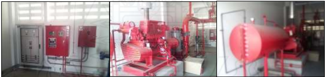
ภาพที่ 1.12 ระบบปั้มน้ำดับเพลิง และระบบสำรองไฟฟ้าฉุกเฉิน
