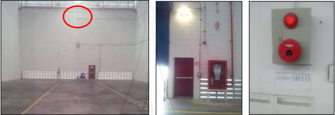
ภาพที่ 1.9 ระบบสัญญาณเตือนภัย อุปกรณ์ตรวจจับควัน และอุปกรณ์ดับเพลิง
