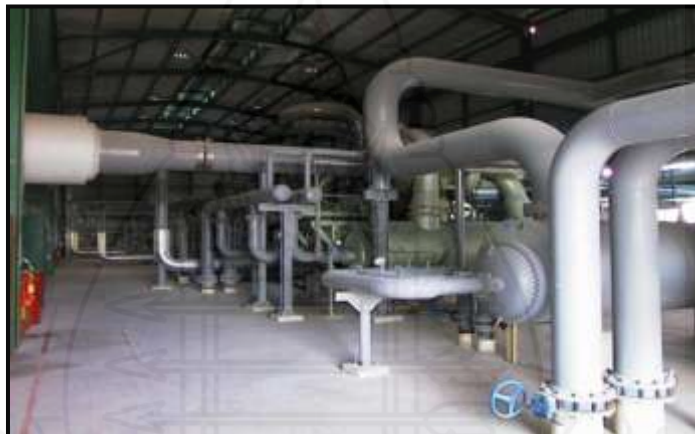
ภาพที่ 3.14 เครื่องดูดอากาศ (Main Air Compressor)
