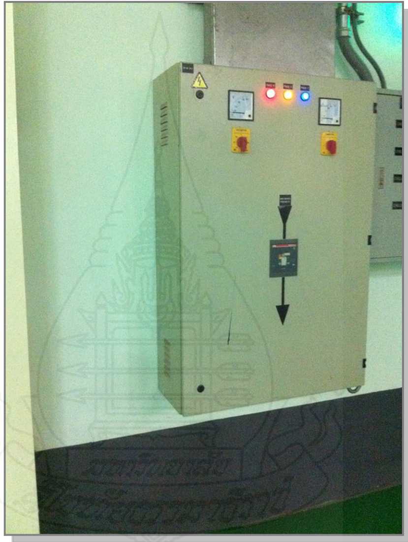
ภาพที่ 2.19 ตู้ควบคุมระบบการส่งจ่ายกระแสไฟฟ้าในโรงงาน
