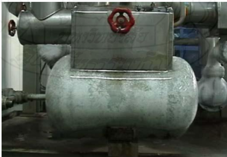
ภาพที่ 4.12 บริเวณถังพักน้ำมันหล่อลื่นที่ต้องถ่ายน้ำมัน
