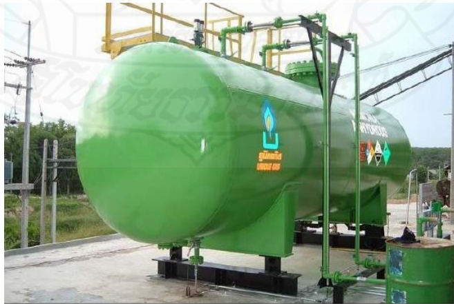
ภาพที่ 4.5 ตัวอย่างถึงความดันเก็บแอมโมเนียด้วยที่ได้มาตรฐาน ที่มา : กองสุขภาพสิ่งแวดล้อม สำนักอนามัย (2554)
