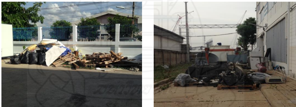
ภาพที่ 3.22 ขยะที่เกิดจากผู้รับเหมาก่อสร้าง
