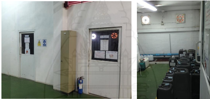
ห้องเก็บสารเคมี กรด-ด่าง และพัดลมดูดอากาศของส่วนซ่อมบำรุง
