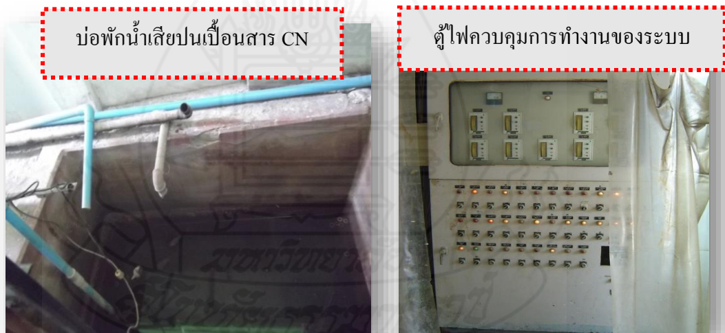
ภาพที่ 4.6 บ่อพักน้ำเสียที่ปนเปื้อนสารไซยาไนด์และการควบคุมจากระบบอัตโนมัติ
