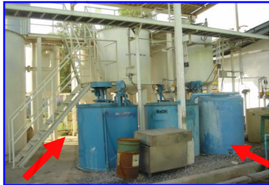
ภาพที่ 5.2 ถังบรรจุสารเคมีของระบบบำบัดน้ำเสีย
