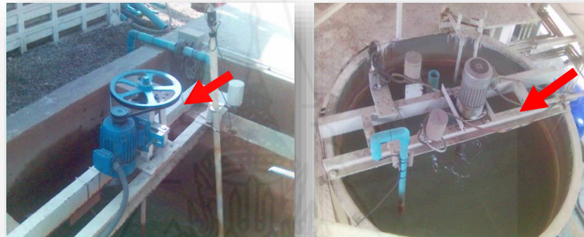
ภาพที่ 5.5 อุปกรณ์ต่าง ๆ ในบ่อและถังรับน้ำเสีย
