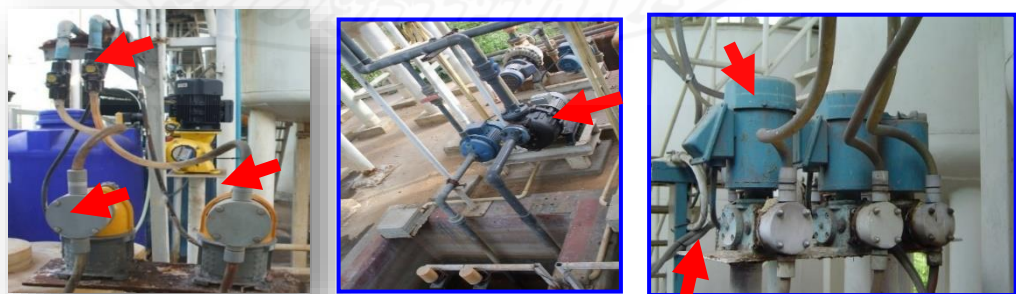
ภาพที่ 5.6 ปั้มน้ำ ปั้มสารเคมี และวาล์วที่ใช้ในการจ่ายสารเคมี
