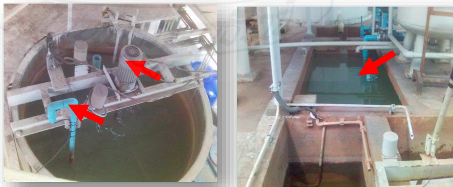
ภาพที่ 5.3 บ่อรับน้ำเสียของระบบบำบัด
