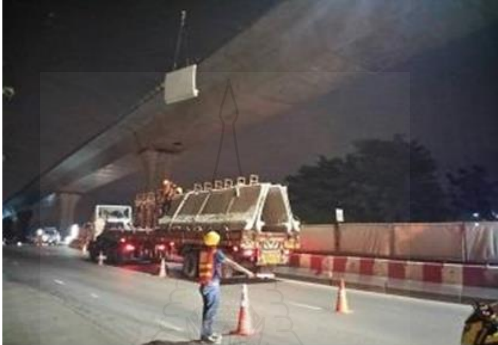
ภาพที่ 4.12 การยกและติดตั้งผนังกันขอบทาง (Parapet)
