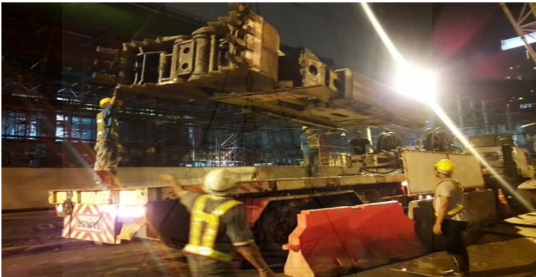
ภาพที่ 2.5 การย้าย, ขนส่งวัสดุและอุปกรณ์ก่อสร้าง
