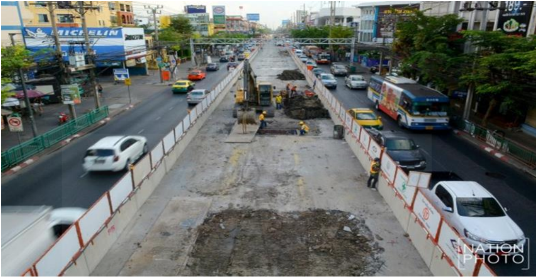
ภาพที่ 2.3 การก่อสร้างฐานราก (Foundation)
