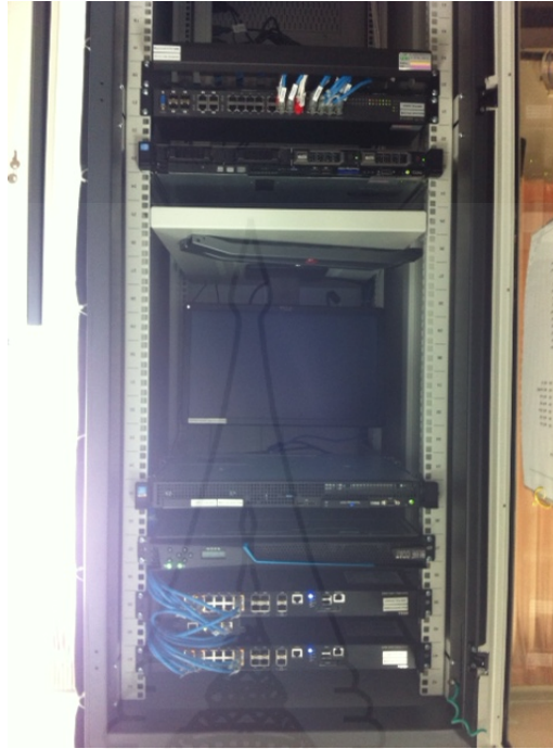
ภาพที่ 4.5 รายการอุปกรณ์ระบบเครือข่ายที่ติดตั้ง
