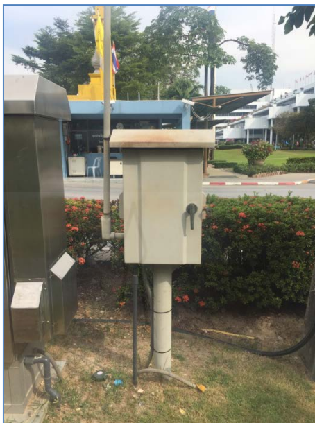
ภาพที่ 3.2 ตู้ RTU
