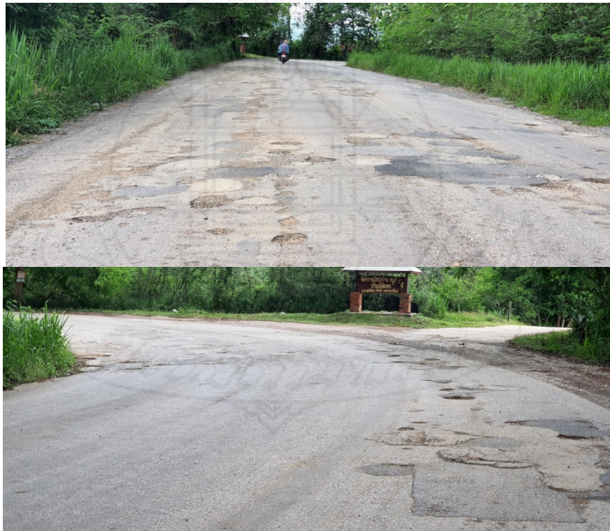
ภาพแสดงเส้นทางสัญจรบนถนนลาดยางที่ชำรุดเสียหาย และไม่มีไฟฟ้าตามเส้นทาง ของหมู่ 4 - 5
