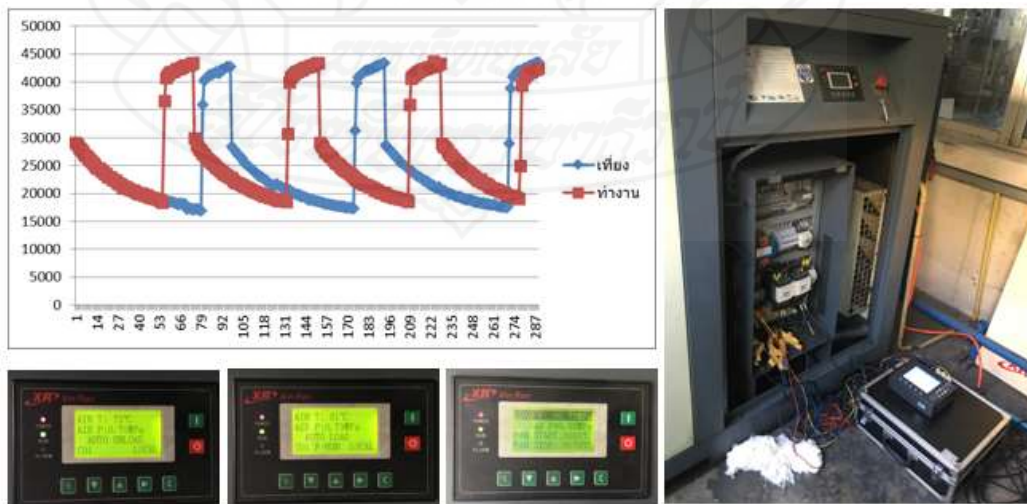
ภาพที่ 4.13 การตรวจวัดประสิทธิภาพเครื่องอัดอากาศของโรงพิมพ์
