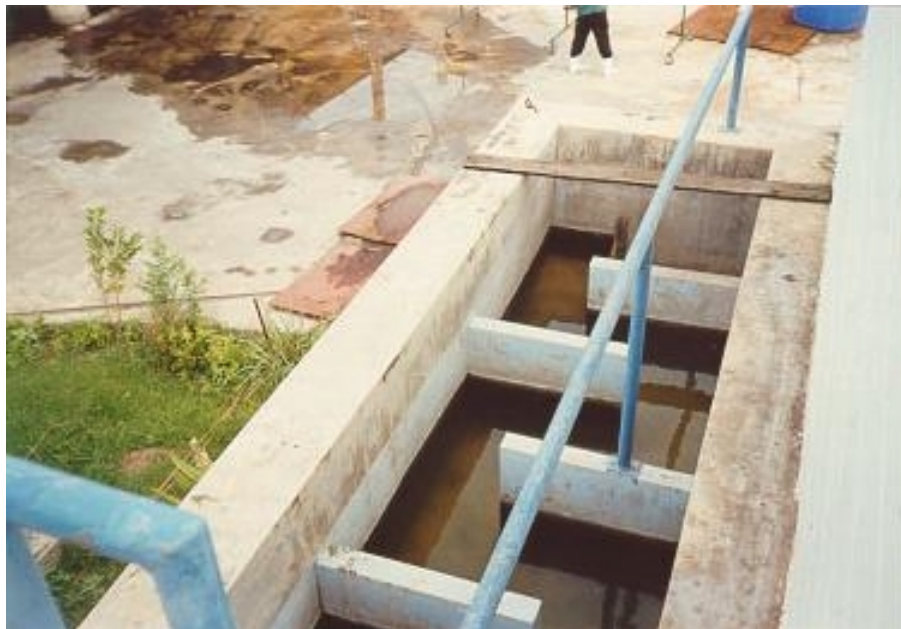
ภาพที่ 3.2 บ่อพักน้ำเสียก่อนปล่อยลงสู่แหล่งน้ำสาธารณะ เป็นจุดเก็บตัวอย่างน้ำเสียหลังการบำบัดขั้นที่ 2
