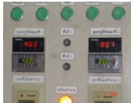
ตู้ควบคุม (Control Panel)
