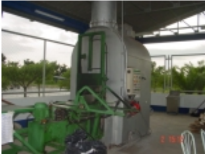
เตาเผาชนิดควบคุมอากาศขนาด 100 กก./ชม
