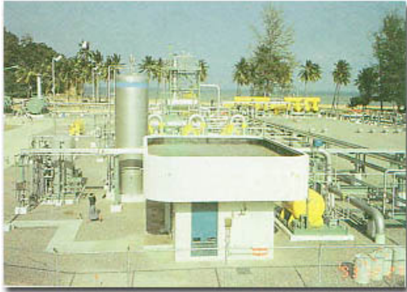
โรงไฟฟ้าพลังความร้อน
