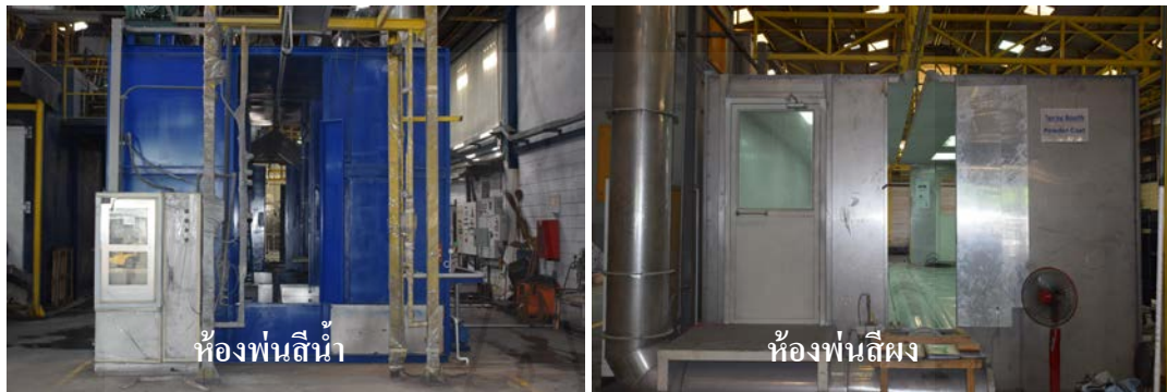
ภาพที่ 4.5 สายการพ่นสีน้ำและพ่นสีผง (อาคาร S-3 และ อาคาร S-4)
