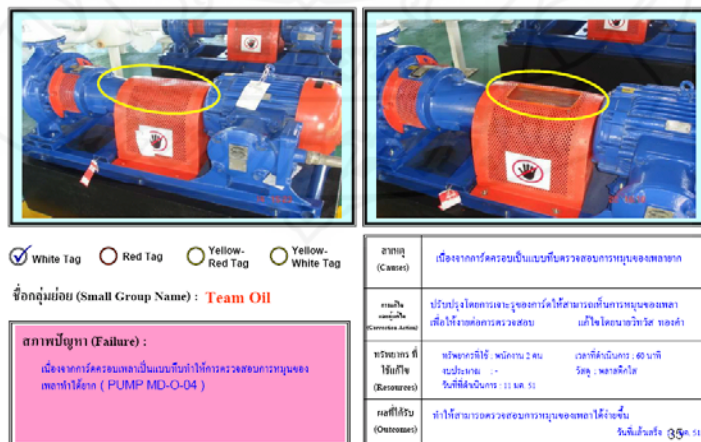
ภาพที่ 3.7 การติดป้ายเมื่อพบจุดบกพร่อง
