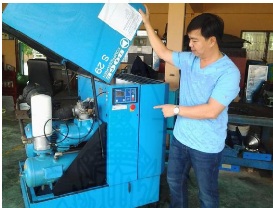
ภาพที่ 2.3 เครื่องปั๊มลมแบบสกรู (Screw Air Compressor)
